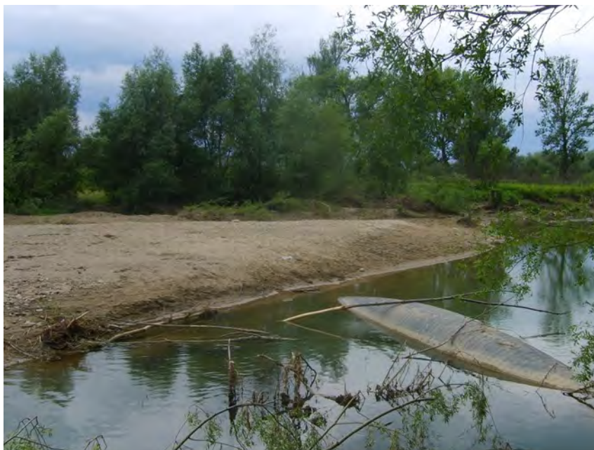
Zdj. 1. Kolektor PE do oczyszczalni ścieków w Nowym Sączu DN1400 (3,4 km) podczas powodzi w 2010. Rok budowy 1995 (fot. Kazimierz Kudlik)
